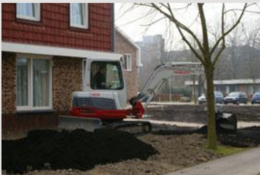
Verwerken van compost bij de aanleg van de beplanting op het terrein van Vincentius.
